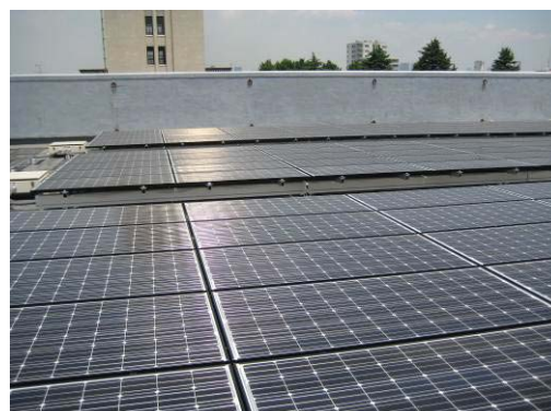
本館屋上の太陽光パネル 左奥に時計台が見えている
